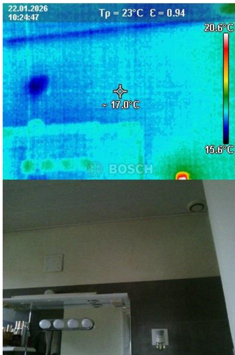
RELEVÉ CAMERA THERMIQUE_Pont thermique plancher haut/mur
